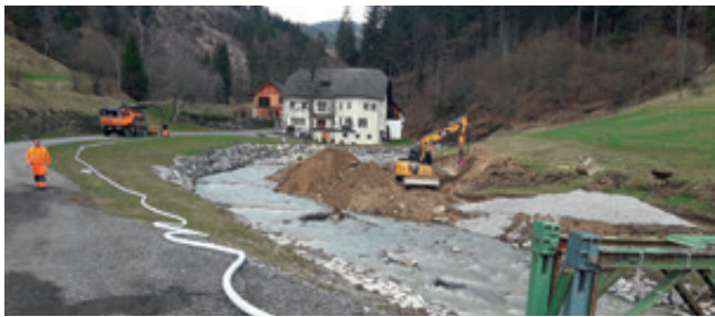
Wiederherstellung des Abwasser-Kanalnetzes nach der Unwetterkatastrophe, von der Klamm, Innere Einöde, bis nach Treffen, durch den Wasserverband Ossiacher See (WVO).
