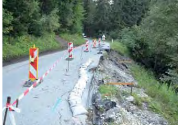
Hangrutschung Gerlitzenstraße unter der Keuschlerwiese
