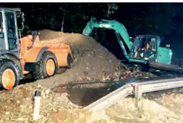
Überflutungen: Die Millstätter Straße im Bereich Einöde
