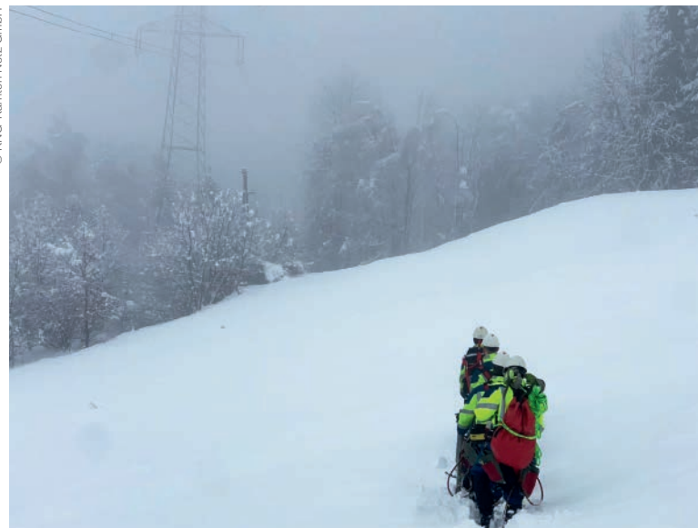
Die Monteure der KNG kämpfen sich durch die Schneemassen zu den beschädigten Stromleitungen.
