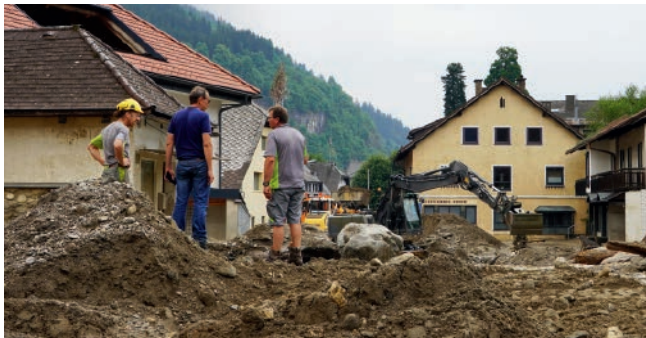
Schweres Gerät musste von der WLV herangeschafft werden, um Verkehrswege freizubekommen und Orte zu erreichen.
